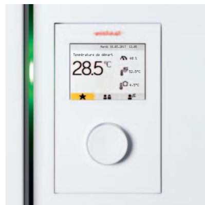
La commande s'opère sur la chaudière, via un smartphone ou un PC
