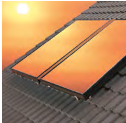
Zonnecollectoren helpen om het gasverbruik aanzienlijk te reduceren.
